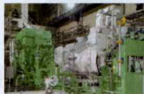
蒸気タービン発電機
